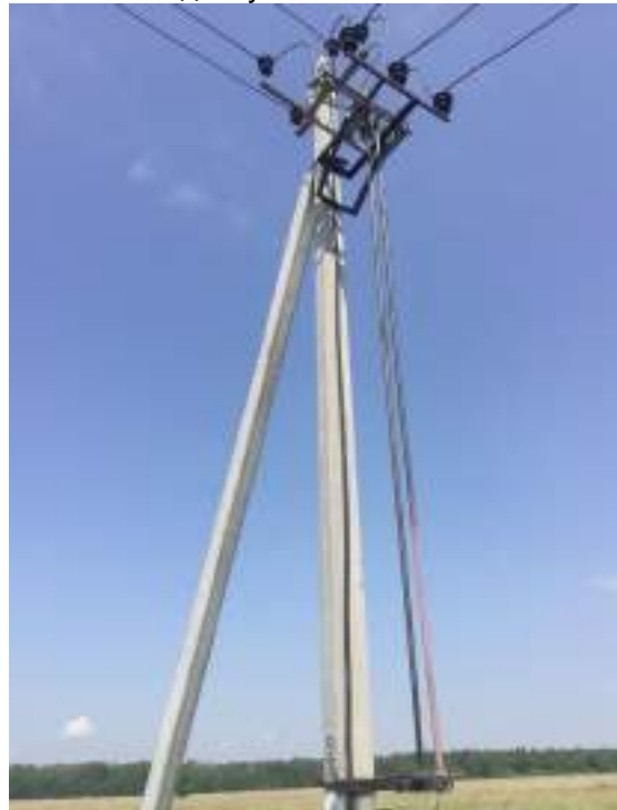
Фото 54. Вид на коммуникации ЛЭП
