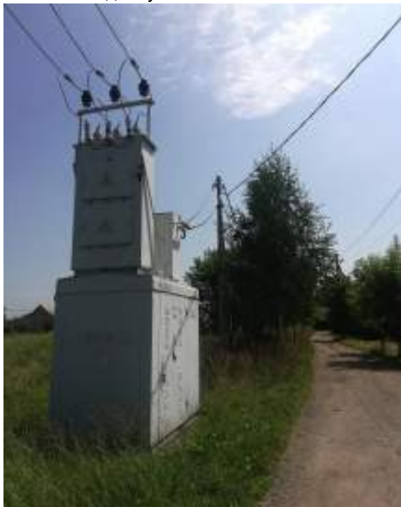
Фото 53. Вид на коммуникации электроснабжения
