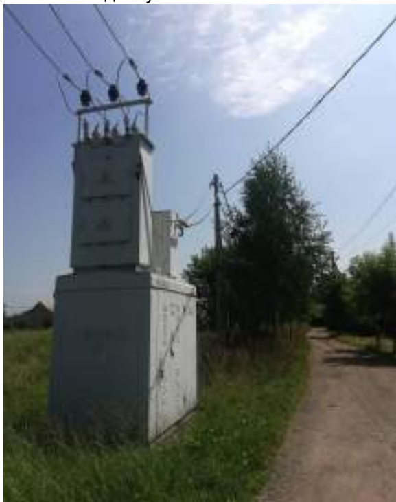
Фото 53. Вид на коммуникации электроснабжения
