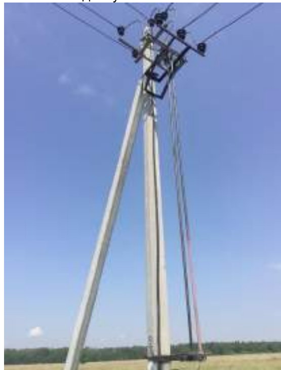
Фото 54. Вид на коммуникации ЛЭП
