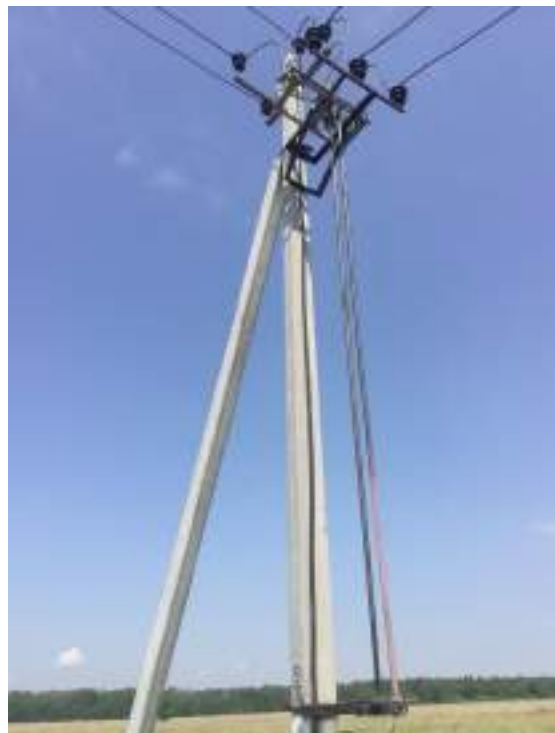
Фото 40. Вид на коммуникации ЛЭП
