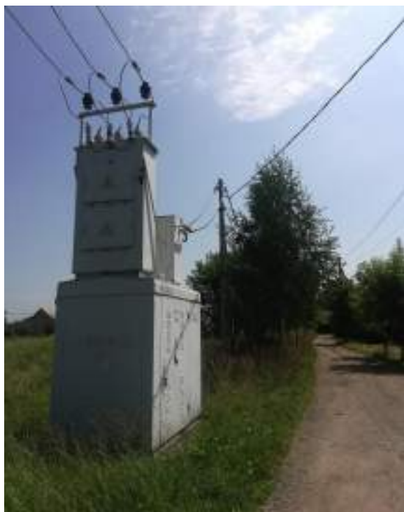
Фото 39. Вид на коммуникации электроснабжения
