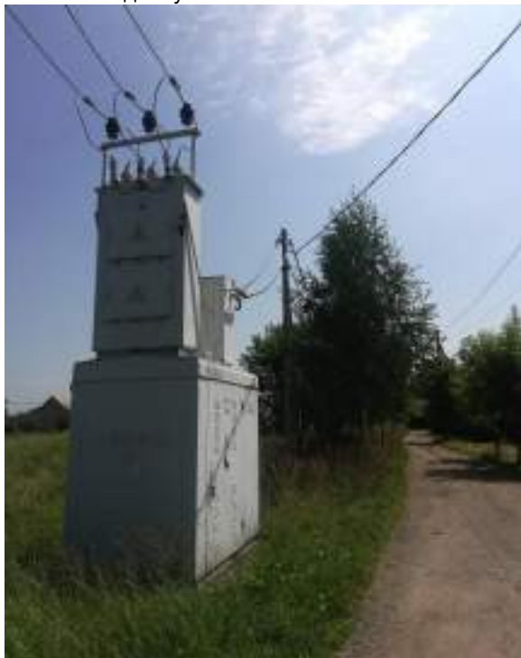
Фото 39. Вид на коммуникации электроснабжения
