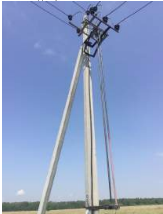
Фото 40. Вид на коммуникации ЛЭП
