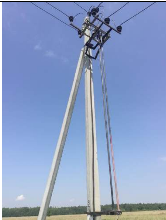
Фото 32. Вид на коммуникации ЛЭП
