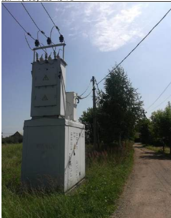
Фото 31. Вид на коммуникации электроснабжения
